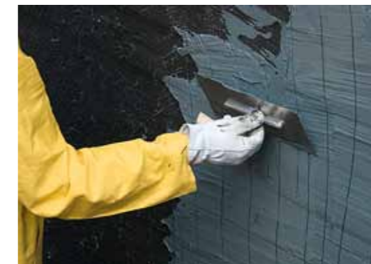
7. Auf die ausgehärtete Haftbrücke wird die erste Abdichtungslage z.B. mit einer Schichtdickenkelle oder Glättkelle aufgetragen.
