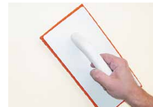
9. weber.cal 286 zur Egalisierung der Oberfläche in 2-3 mm Dicke aufspachteln und nach ausreichender Trocknung als Oberflächen-Finish erneut aufbringen und strukturieren.
