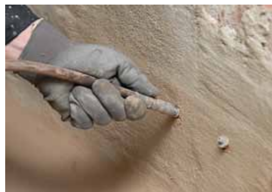
4. Bohrlöcher mittels ölfreier Druckluft vom Bohrstaub befreien und Horizontalsperre weber.tec 940 im Niederdruckverfahren über eingebrachte Packer injizieren. Bei Hohlräumen vorab weber.tec 942 einbringen.
