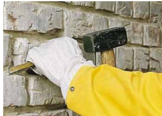
1. Der Altputz wird bis mind. 80 cm oberhalb der schadhaften Zone abgeschlagen. Fugen 2 cm tief auskratzen und mit weber.tec 933 auffüllen. Im Bereich Boden/Wandabschluss wird eine 4x4 cm tiefe Nut ausgestemmt.
