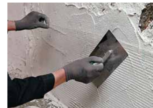
9. Sanierputz wird auf Dichtungsschlämme im Regelfall einlagig verarbeitet. Im oberen Drittel wird dabei das Armierungsgewebe weber.sys 987 eingearbeitet.
