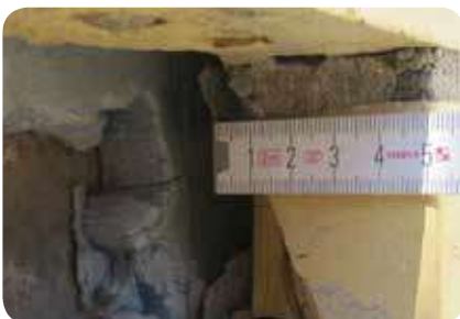
4. Sparverblender II ( d = 55 \text{ bis } < 90 \text{ mm} ) im Mörtelbett auf tragfähigem Untergrund. Teilflächige Ablösung der Verblender von der Mörtelschicht/tragenden Wand
